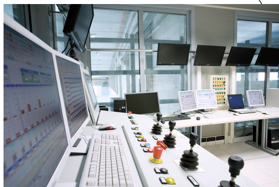
(1) SISTEMA DI VENTILAZIONE CONTROLLATO IN AUTOMATICO 24/7
